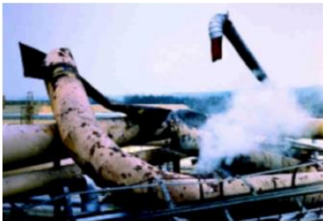
Fissuration d'une ligne de torche sur le champ de Lacq. (Source : Crolet, Eurocorr 2001)
